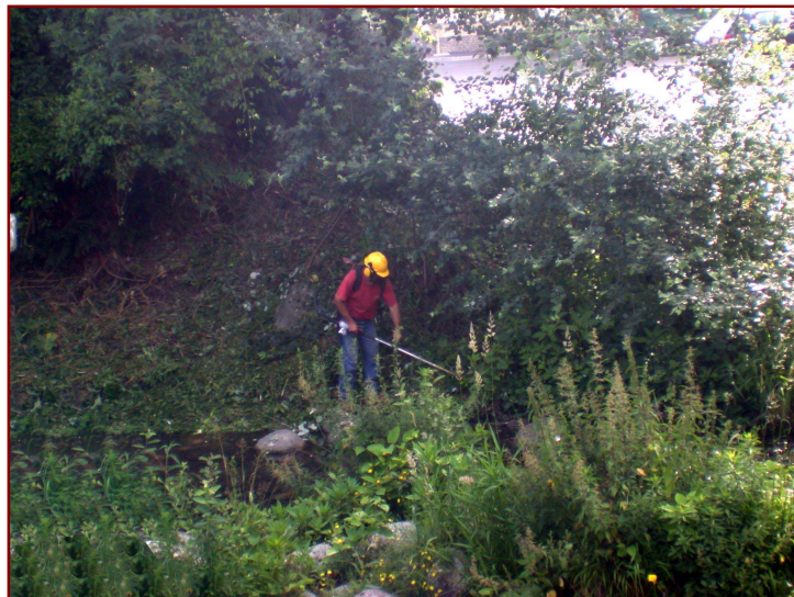
Débroussaillage des berges de l'Adour par un agent de la Brigade Verte
